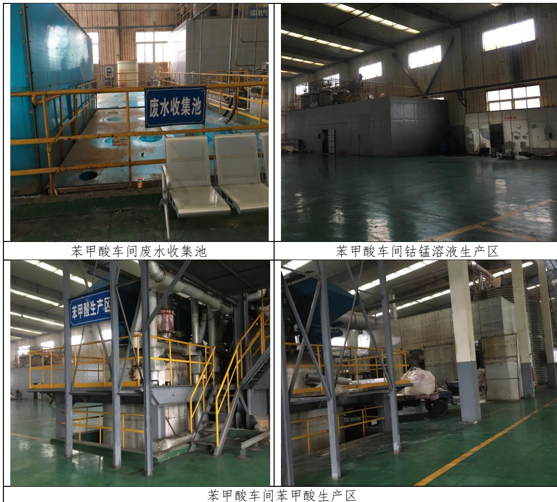
图 3.2-2 苯甲酸车间现场情况
