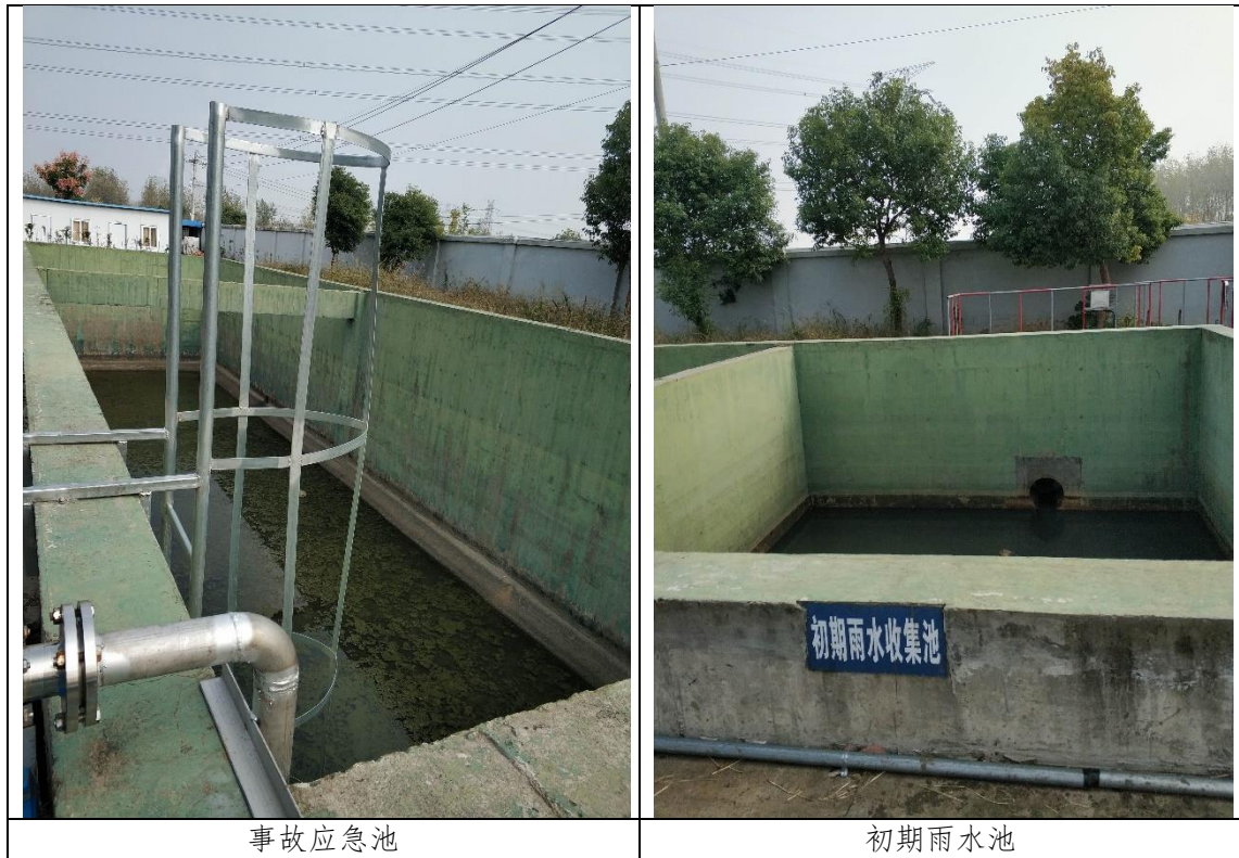
图 3.2-8 事故应急池和初期雨水池现场情况
