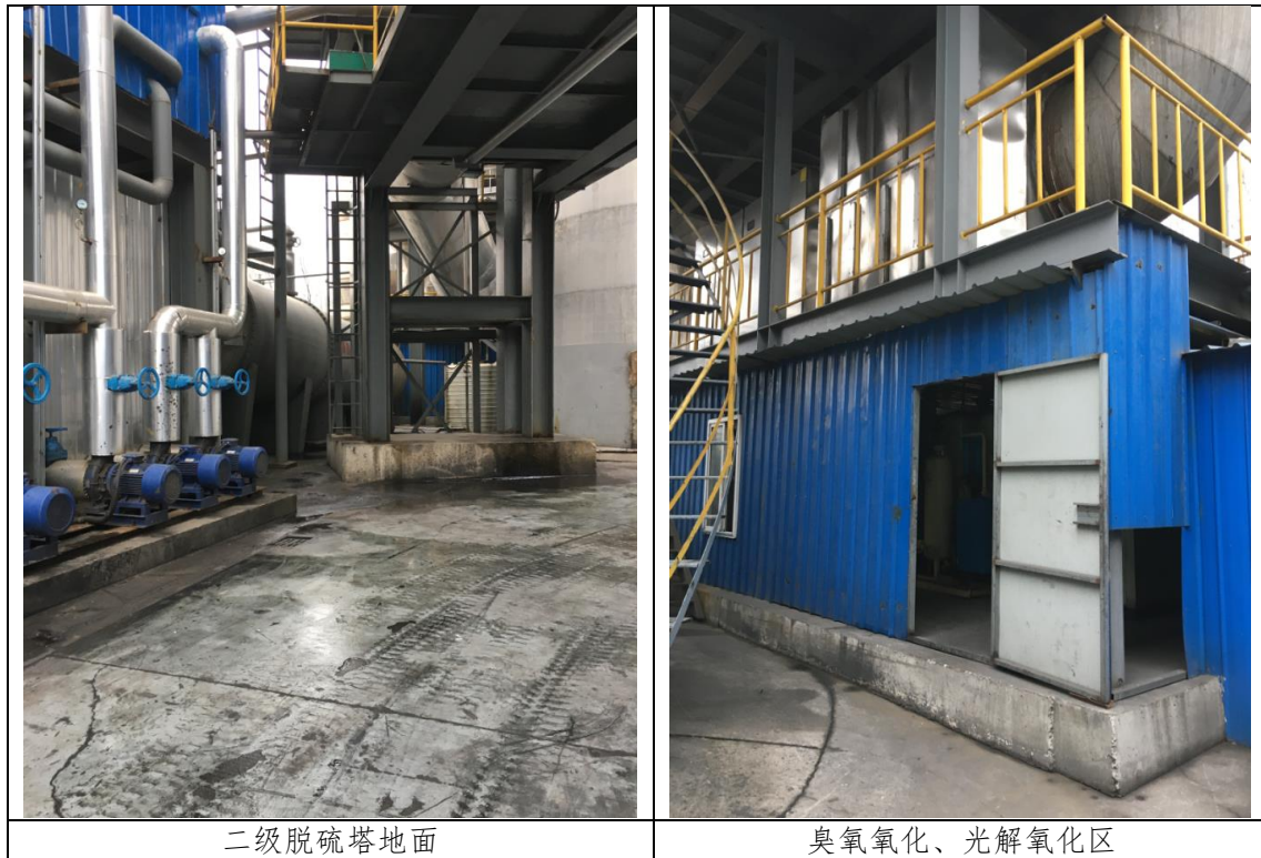
图 3.2-9 回转窑炉废气处理区现场情况
